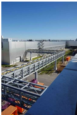
Bild 02: Über kilometerlange Leitungen werden die einzelnen Bereiche im Werk 2.40 mit der Energie aus der neuen KWK-Zentrale versorgt.
