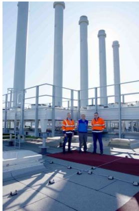
Bild 01: Der Projektleiter für den KWK-Neubau Herbert Brunmeier, der Leiter für Energiebetrieb und Werkstätten Roland Zeller sowie der Planer für Versorgungstechnik Erwin Fischer (von rechts nach links) auf dem Dach der neuen KWK-Zentrale im BMW Group Werk Dingolfing.
